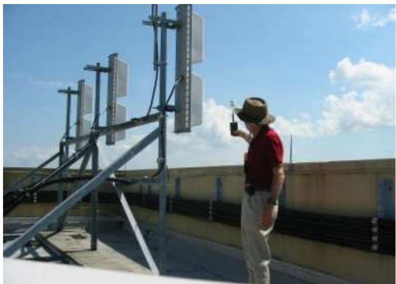
屋上に設置した中継アンテナ周辺の電界強度測定
